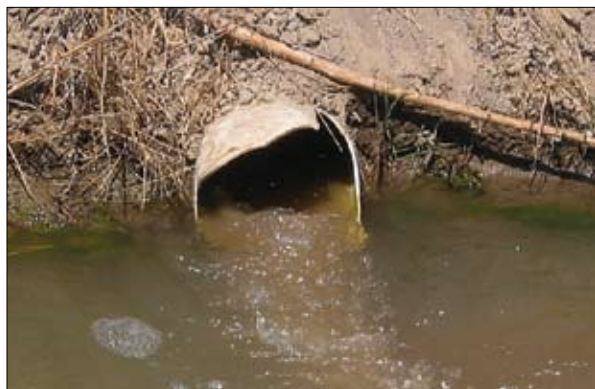
Figura 4. Aguas de escorrentía en un campo de cebollas donde no hay protección contra la erosión.
